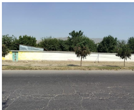
Затронутая ограждающая стена жилого объекта
