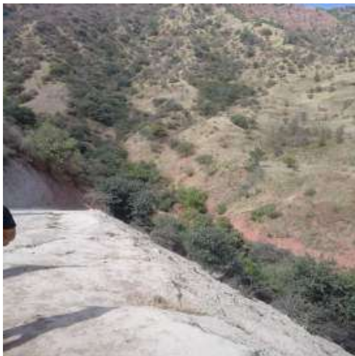
Рисунок 10– Существующая дорога на км 9,3 с серьезными недостатками безопасности
